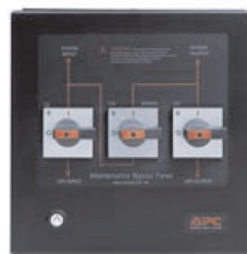
Bypass de manutenção
